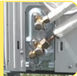
室外機 カバー内部 バルブ室
