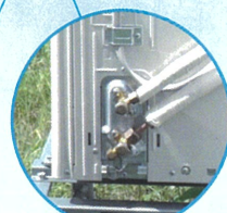
室外機カバー内部
